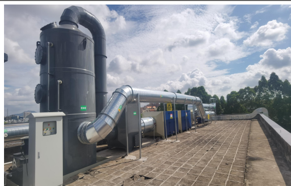
水喷淋塔+除雾过滤器+二级活性炭箱
