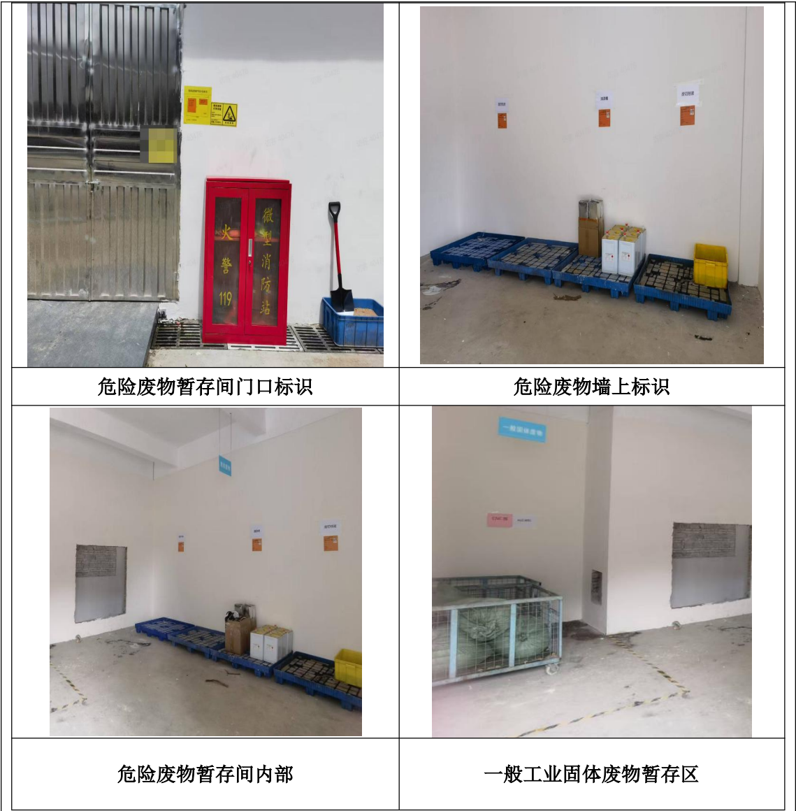
图 2-12 固体废物环保设施竣工建成现状图片
